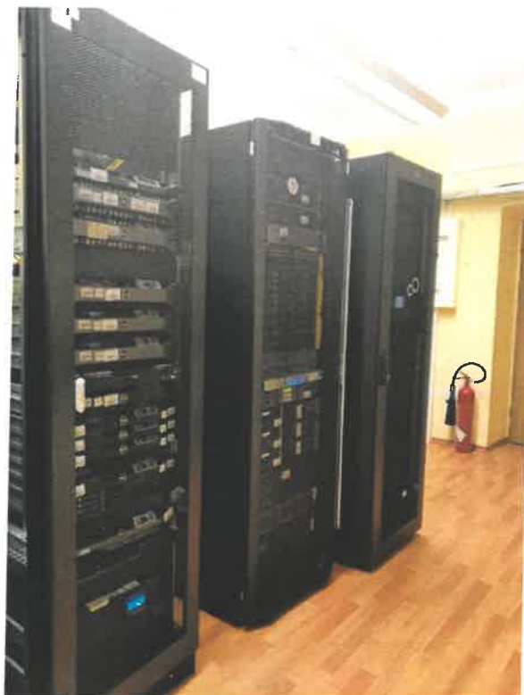
Zdjęcie nr 18: Zdjęcie ogólne serwerowni.
